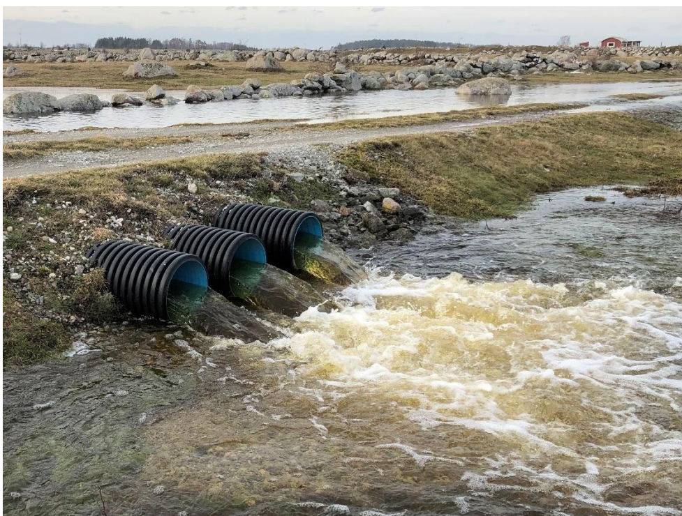
Utloppet vid Egby i slutet av februari 2021. Trummorna utgör ett partiellt vandringshinder för fisk och ställer till problem vid såväl höga som låga vattenflöden.
